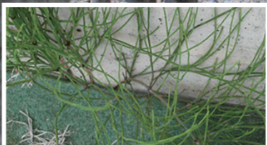
コンクリート等の境目からの雑草
